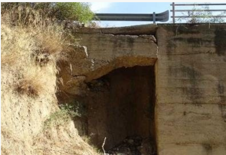
OPERA 01 Degrado delle strutture
