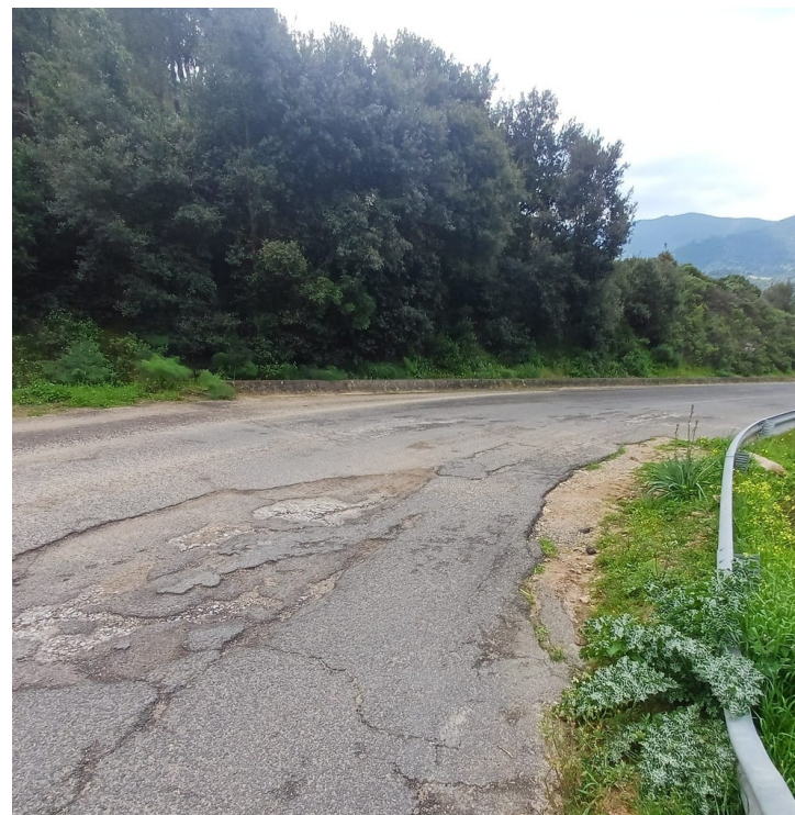
ZONA B Degrado del piano viabile
