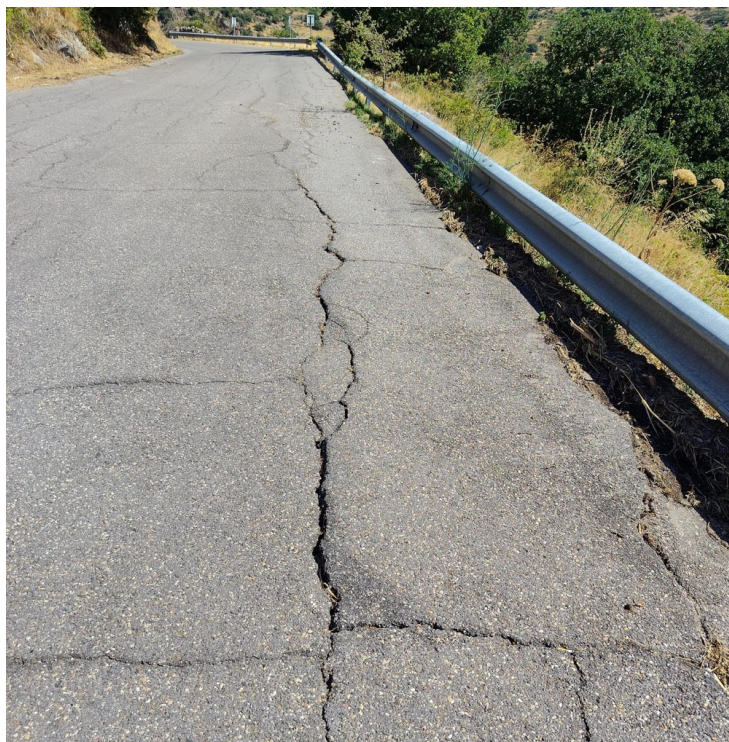
ZONA A Fessurazioni longitudinali
