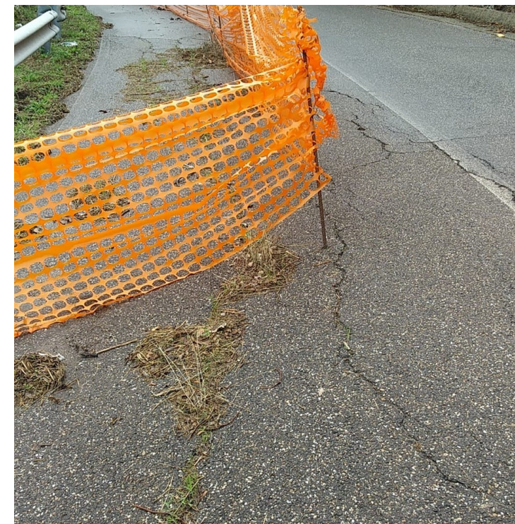
ZONA C Dissesto e delimitazione
